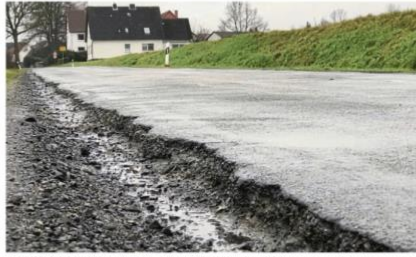
Bräuselige Bankette: Die Kreisstraße K100 zwischen Wenigenhasungen und Altenhasungen wird im Sommer saniert. Danach wird sie zur Gemeindestraße.
